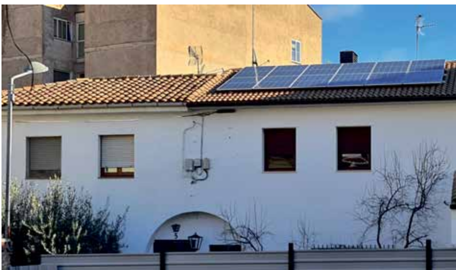
Los tejados de muchos inmuebles binefarense ya incorporan placas fotovoltaicas.
